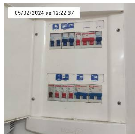
1.13. Caixa de disjuntores
