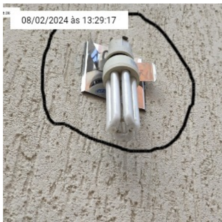
12.7. Luminária (falta a proteção)
