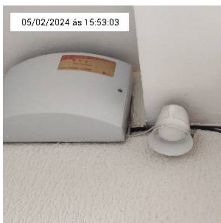
12.2. Central de cerca eletrica/cerca elétrica
