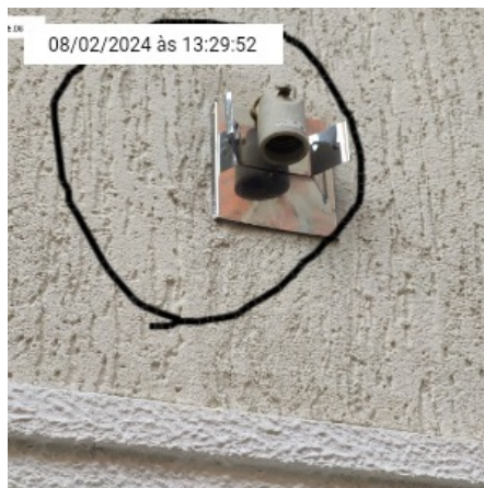
12.7. Luminária (falta a proteção da lampada)
