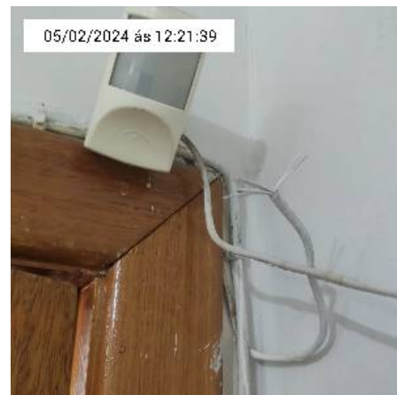
1.12. Central de alarme
