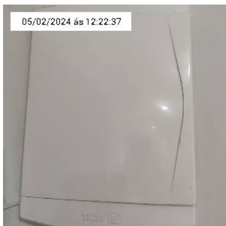
1.13. Caixa de disjuntores
