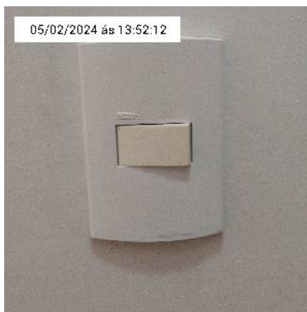
7.4. Tomadas e Interruptores
