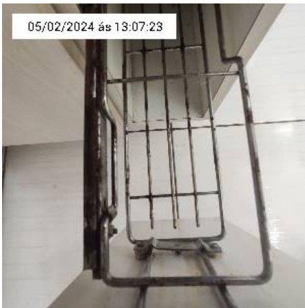
3.9. Balcão da pia (Grade da gaveta de tempero está com ferrugem)
