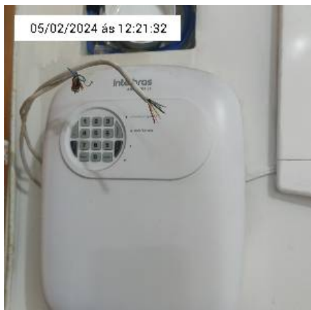
1.12. Central de alarme
