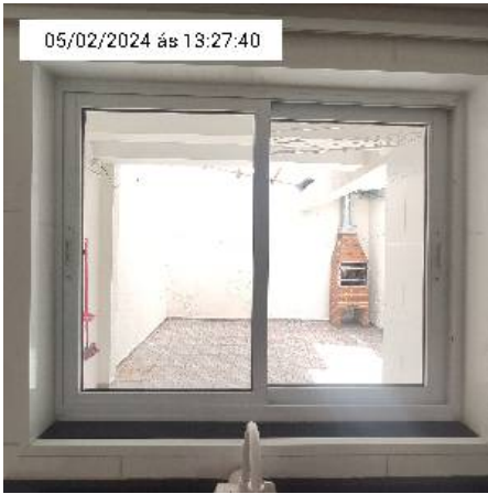
3.14. Janela e esquadrias
