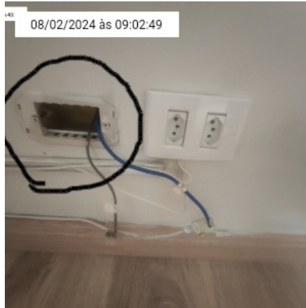
8.7. Tomadas (falta o espelho de proteção no conector da internet)
