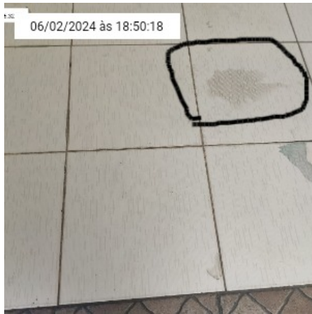
5.1. Piso (Mancha no Piso)
