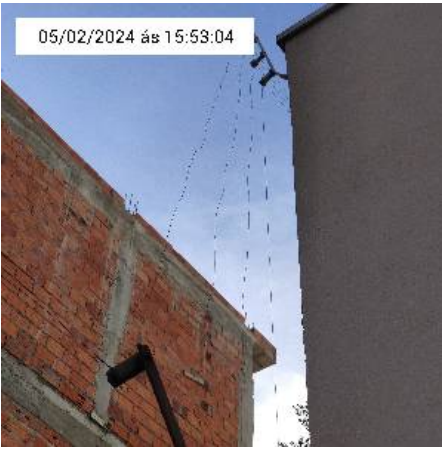
12.2. Central de cerca eletrica/cerca elétrica
