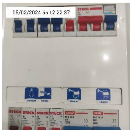
1.13. Caixa de disjuntores
