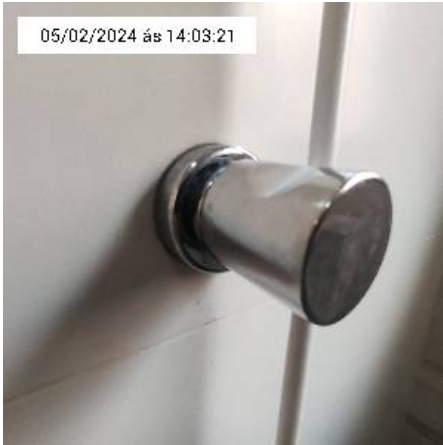
6.13. Registro de água
