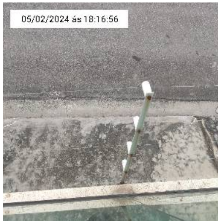
12.2. Central de cerca eletrica/cerca elétrica
