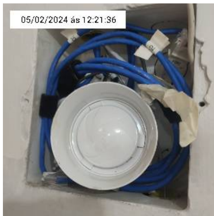
1.12. Central de alarme
