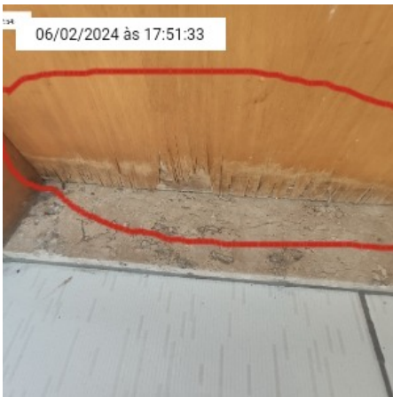
3.1. Porta/Batente/Fechadura/Chaves (porta com a parte de baixo desgastada)
