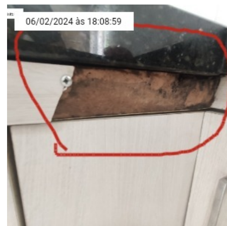
3.8. Gabinete da pia (Está com uma parte da frente danificada)
