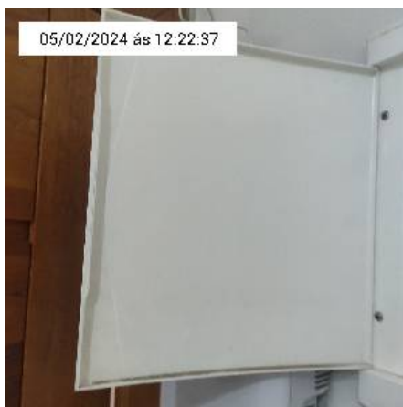
1.13. Caixa de disjuntores
